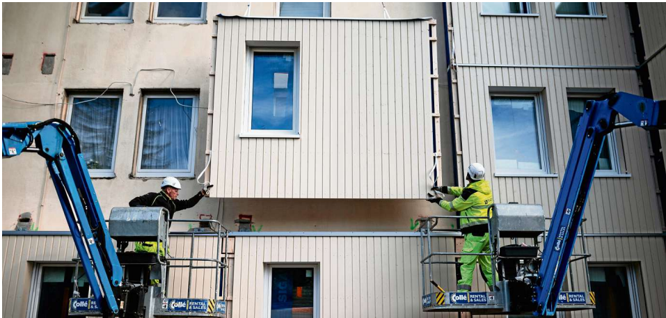
Serielles Sanieren: Arbeiter der LEG montieren ein vorgefertigtes Fassadenelement an ein Mehrfamilienhaus in Mönchengladbach.
